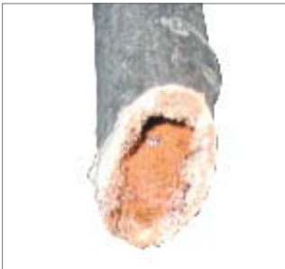
Accumulation de corrosion dans les tuyaux en métal
